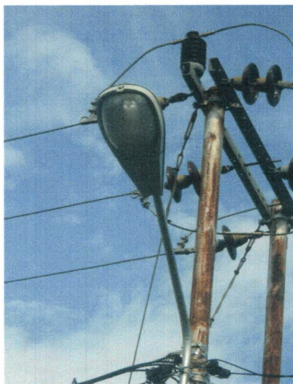
Poto 8. Lampu PJU No. 4 Lokasi : Kec. Sasak Ranah Pasisie. Sebelum Jembatan Sasak
